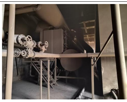
DA003 废气处理装置
