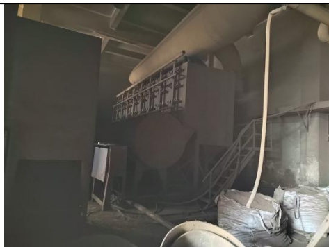
DA002 废气处理装置
