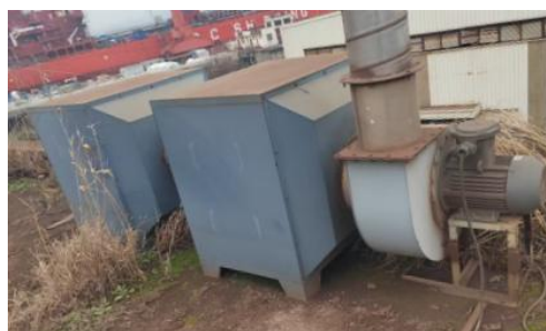
DA004 废气处理装置
