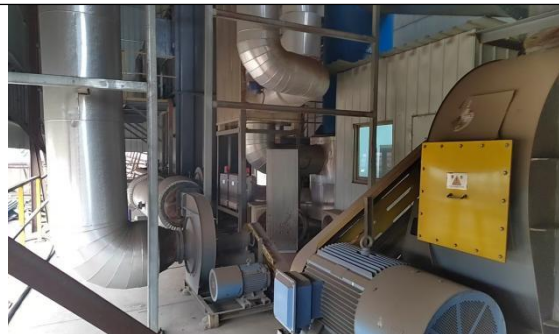
DA001 废气处理装置
