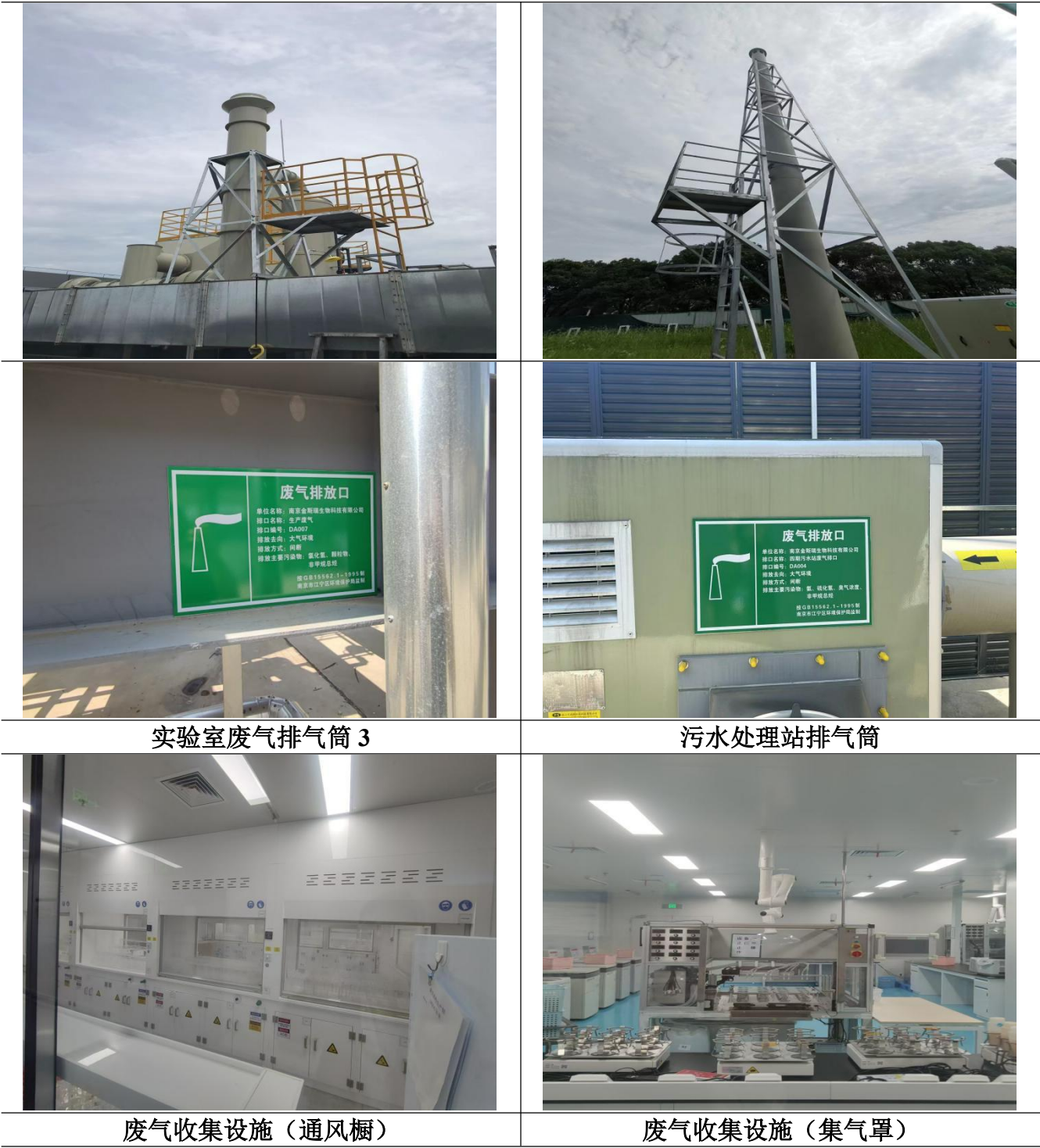
图 4-4 废气收集处理装置照片
