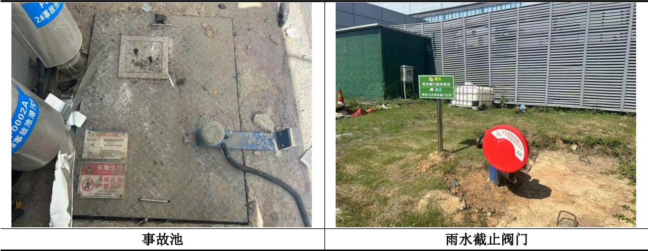
图 4-6 应急设施照片
