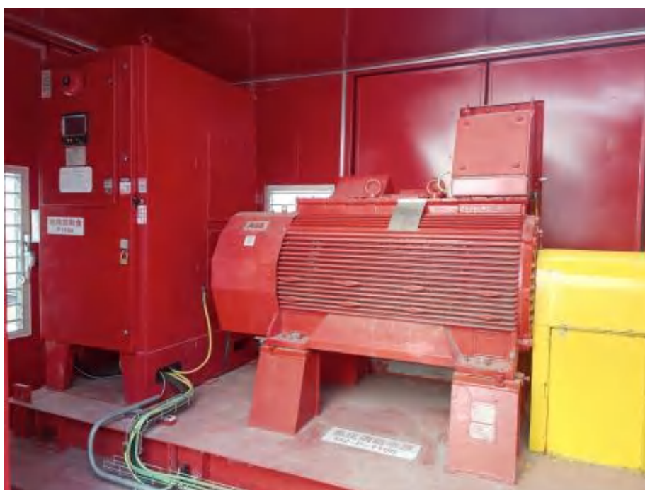
图 3.2.3-8 新增电动消防泵
