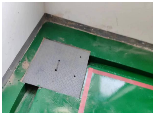
危废仓库导流沟、防渗地面
