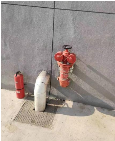
消防栓、灭火器
