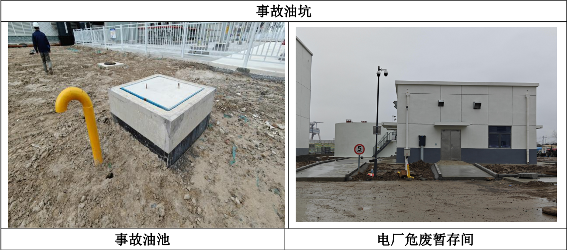
图 10-1 事故油坑及事故油池照片
