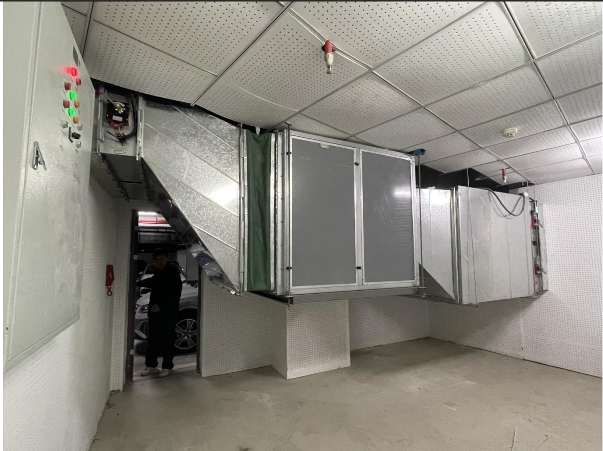
地下车库机械通风换气装置
