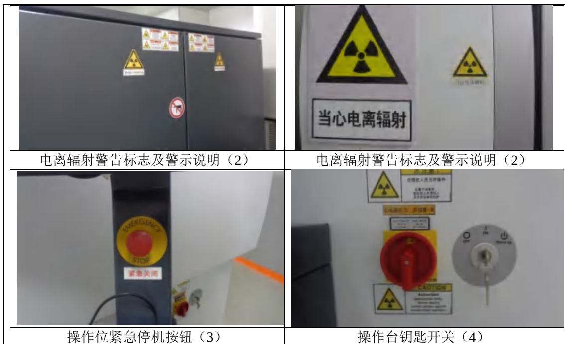
图 3-2 辐射防护安全措施情况现场图
