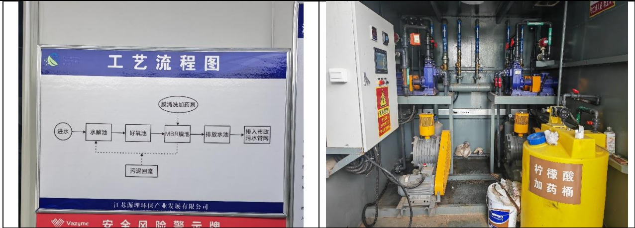
图 3-2 企业自建污水处理设施现场照片
