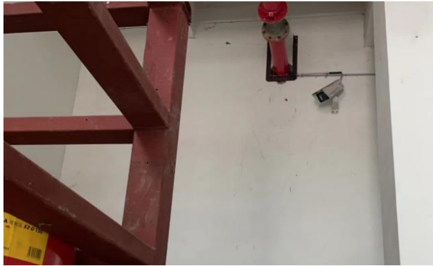
危废库内视频监控
