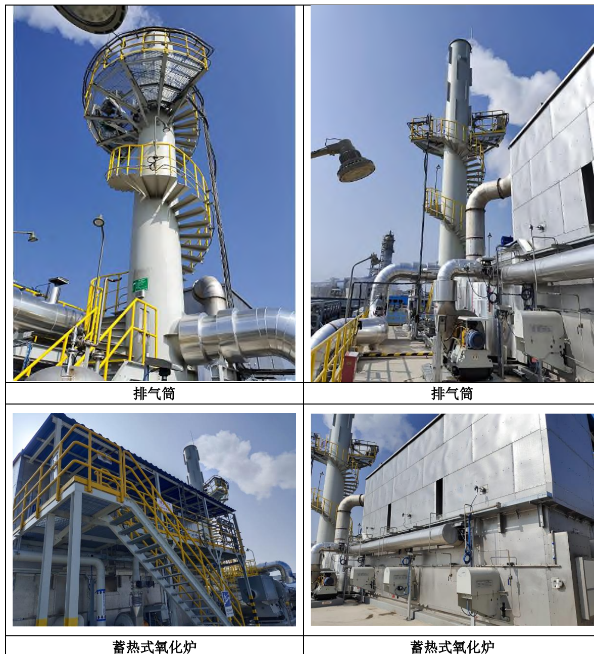
图 3-2 废气处理装置
